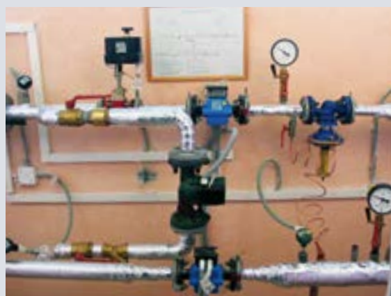
Рис.3. Фото теплового узла после реконструкции.
